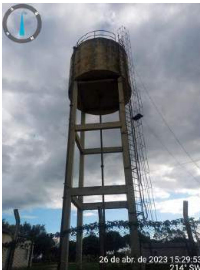
Figura 6-1: Reservatório da comunidade de Assentamento.
