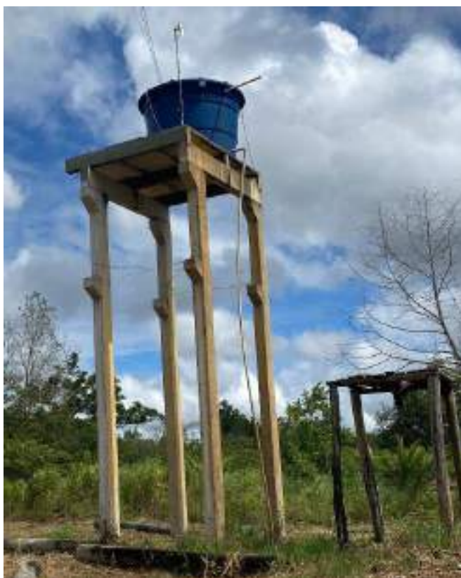
Figura 6-13: Reservatório, Aldeia Amarelos.
