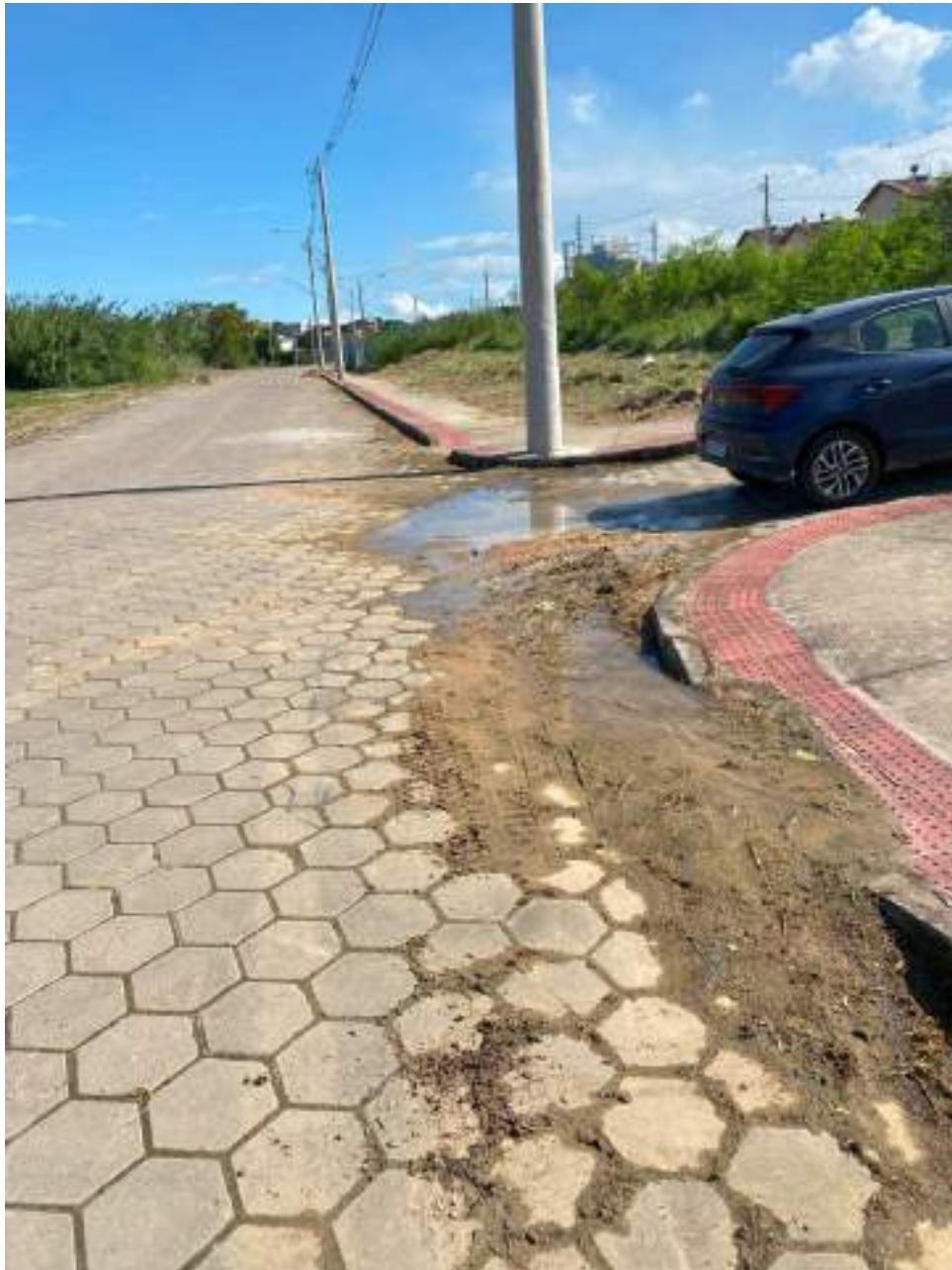
Figura 9-43: Sedimentos carregados para o sistema de drenagem.
