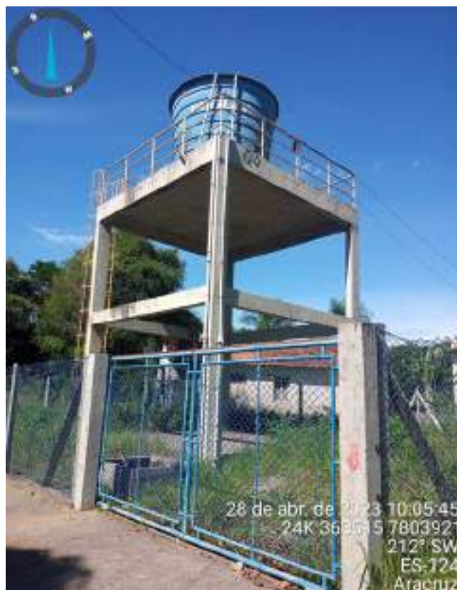
Figura 6-6: Reservatório elevado da comunidade de Grapuama
