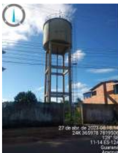
Figura 6-4: Reservatório da comunidade de Córrego D'água
