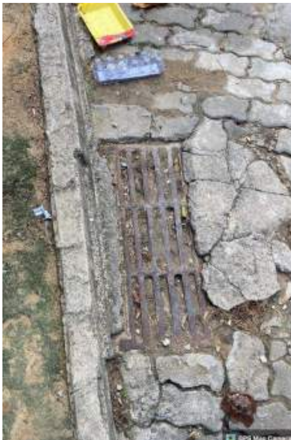
Figura 9-80: Resíduos sólidos e caixa ralo completamente entupida na rua Ipê, jacupemba.
