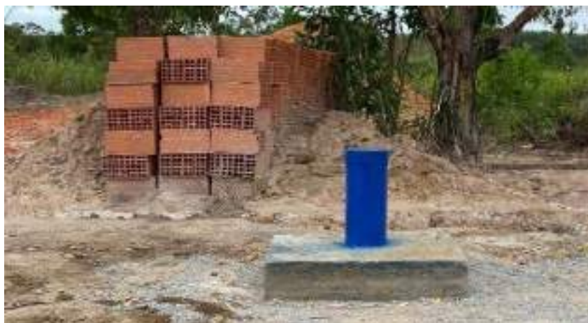
Figura 6-11: Poço artesiano, Aldeia Córrego D'ouro.
