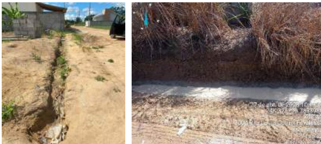
Figura 9-74: Valas de drenagem feitas pelos moradores.
