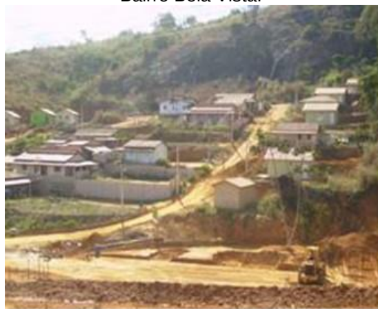
Figura 3.10: Área de desmoronamento – Bairro Bela Vista.
