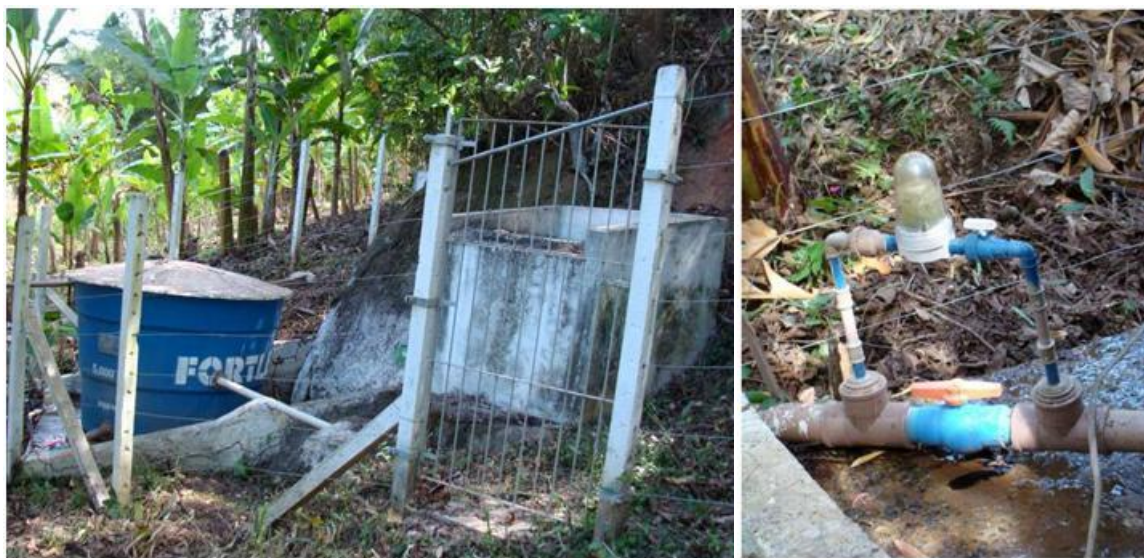
Figura 43: a) Captação do SAA de Duas Barras; e b) Sistema de cloração atualmente desabilitado.
