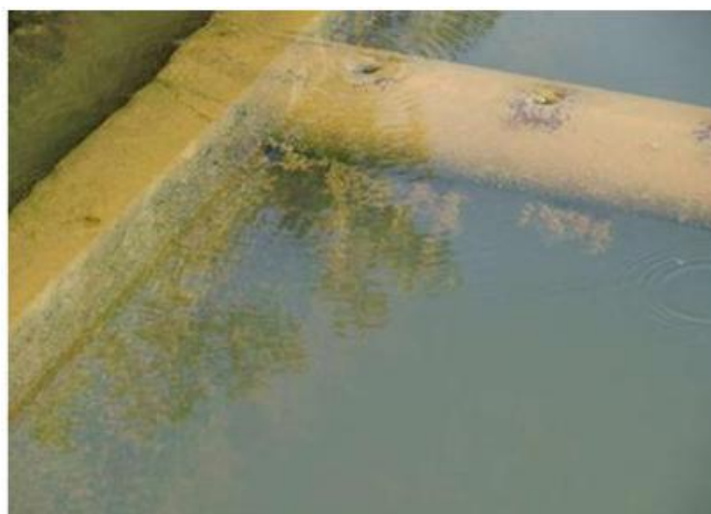
Figura 19: Proliferação de algas nas paredes e canaletas do decantador.
