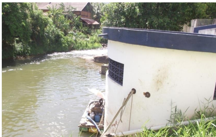
Figura 85: Rio Iconha – Balsa para desassoreamento do ponto de captação de água bruta.
