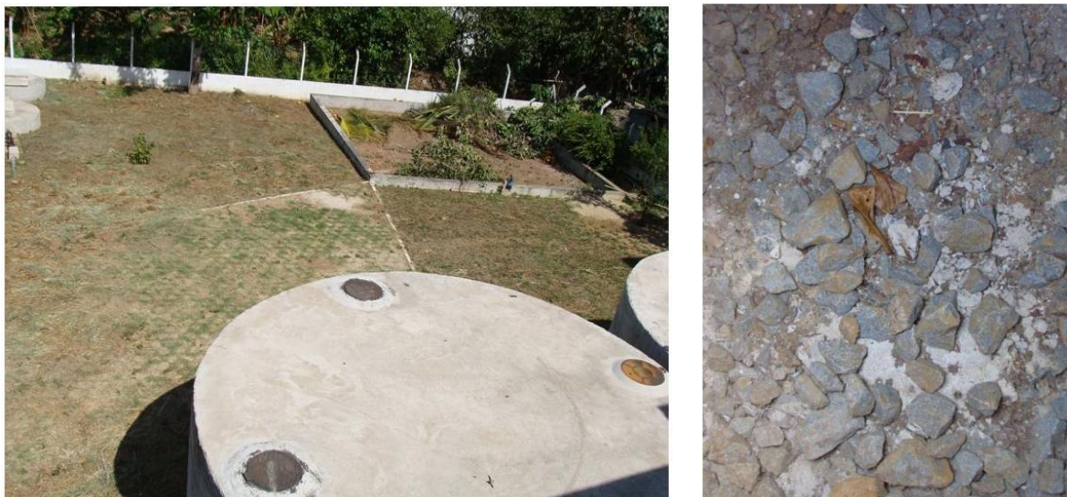
Figura 59: a) ETE da Ilha do Coco com leito ao fundo; e b) Material do filtro colmatado.
