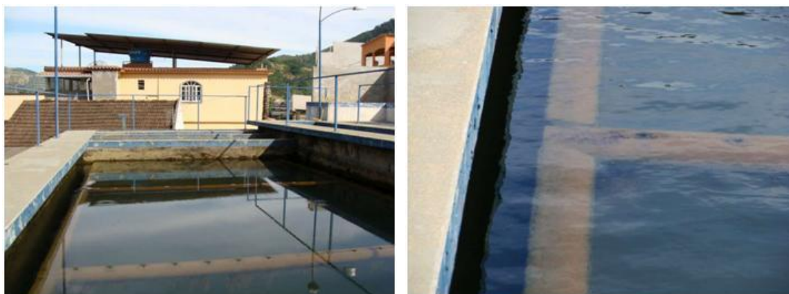
Figura 18: a) Decantador de alta taxa; e b) Decantador operando afogado.
