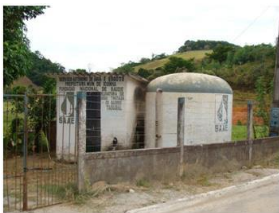
Figura 29: Estação Elevatória de Taquaral.
