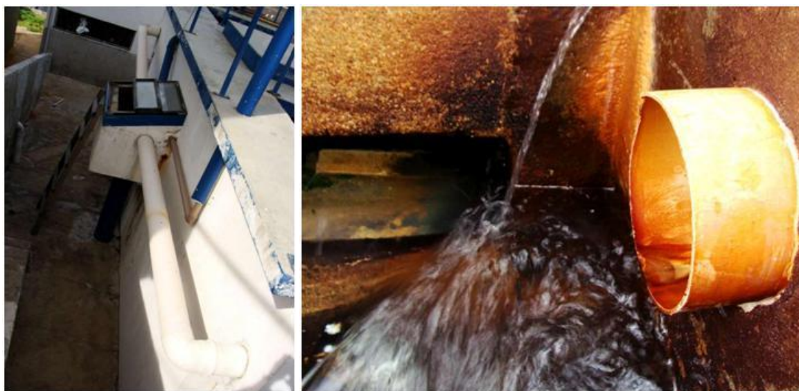
Figura 22: a) Foto externa da saída de água filtrada; e b) Detalhe interno.
