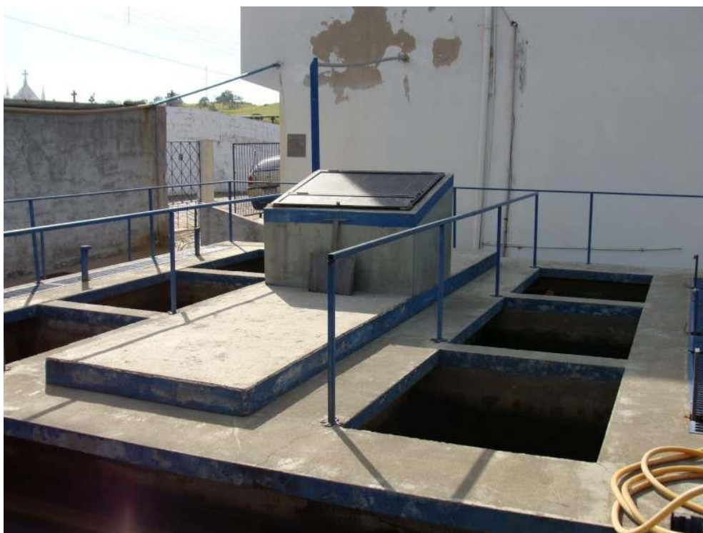
Figura 20: Filtros e reservatório de retrolavagem da ETA de Iconha.
