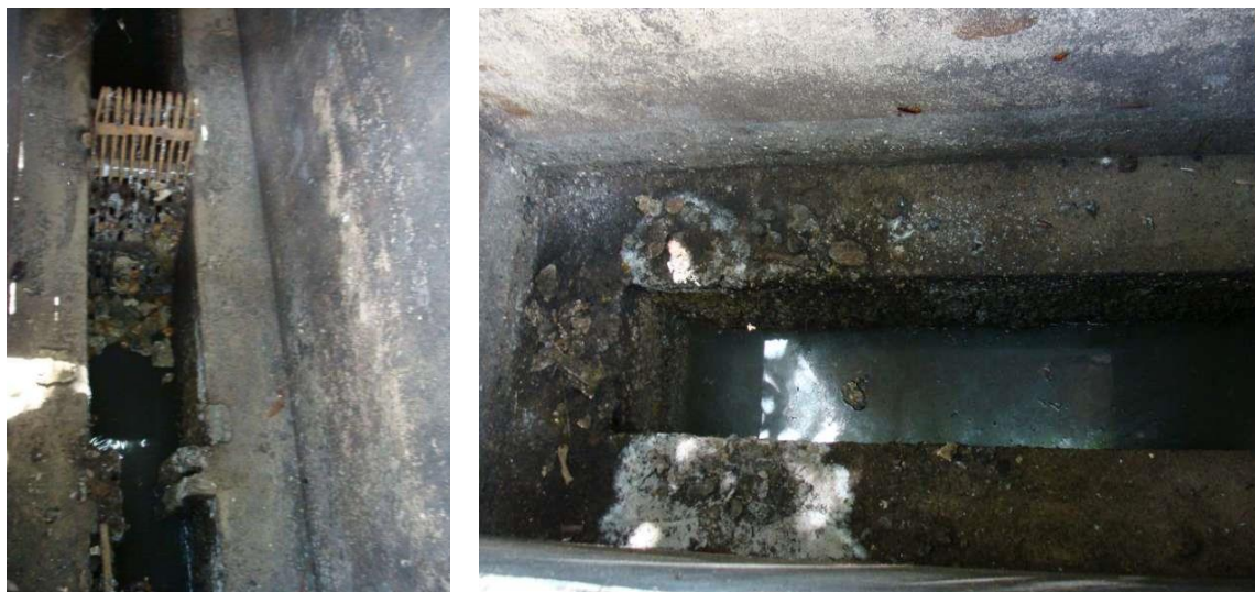
Figura 64: a) Grade obstruída pelo lixo; e b) Caixa desarenadora.
