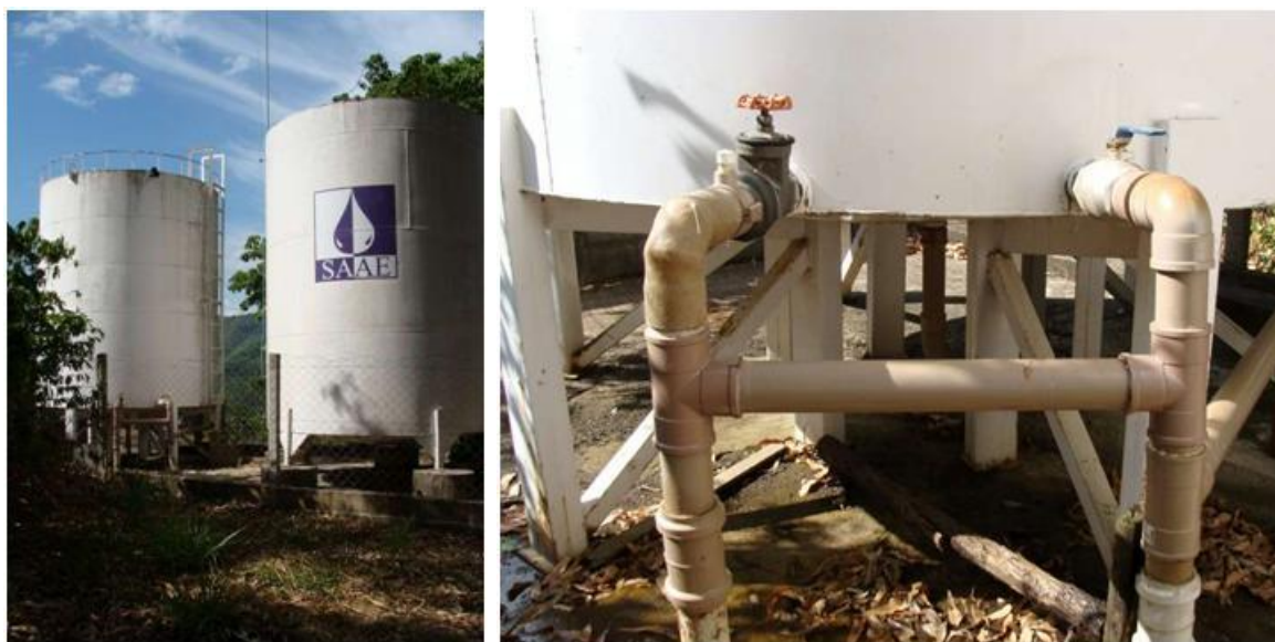
Figura 26: a) Reservatórios de Novo Horizonte e Paraíso; e b) Interligação dos reservatórios.
