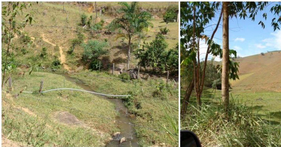
Figura 44: a) Rede atravessando o córrego Santo Antônio; e b) Eucaliptos sobre a rede.
