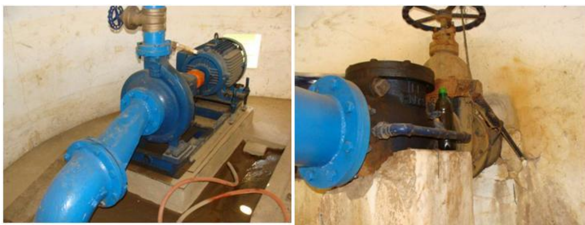
Figura 15: a) Conjunto moto bomba da captação; e b) Danos na parede.
