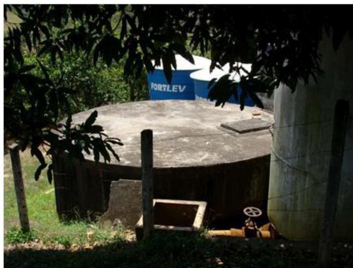
Figura 38: Reservatórios na ETA de Bom Destino.
