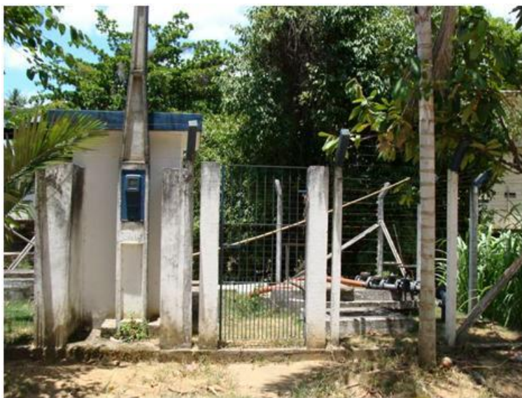
Figura 62: Estação Elevatória de Esgoto (EEE) de Bom Destino/Iconha.
