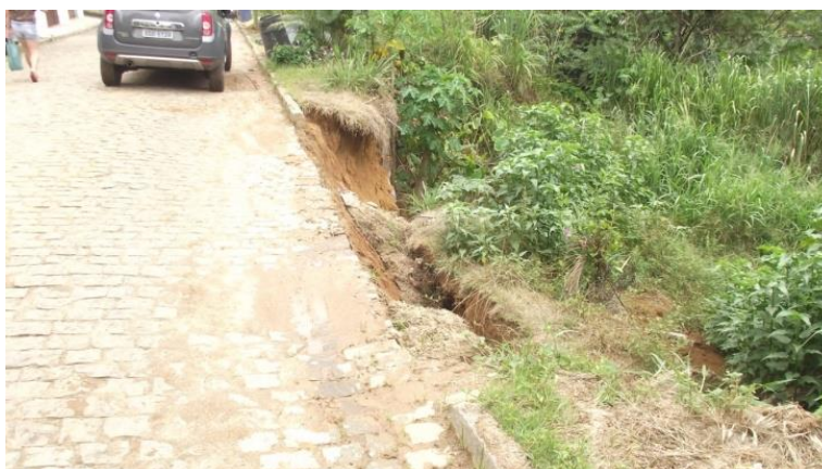
Figura 79: Bairro Jardim Da Ilha – erosão junto ao meio-fio.
