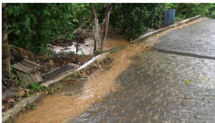
Figura 80: Bairro Paraíso – drenagem em má condição de funcionamento.
