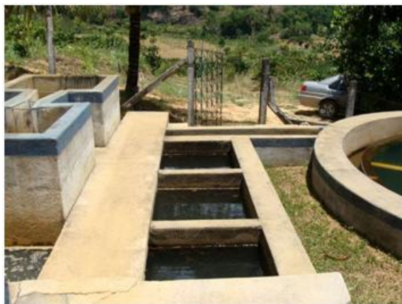
Figura 35: Floculador hidráulico SAA Bom Destino.
