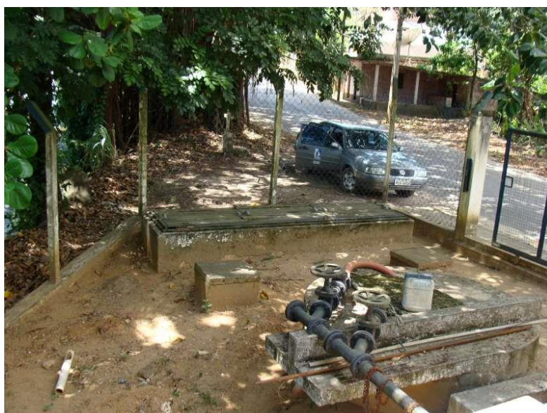
Figura 65: Pré-tratamento e EEE da ETE de Bom Destino.
