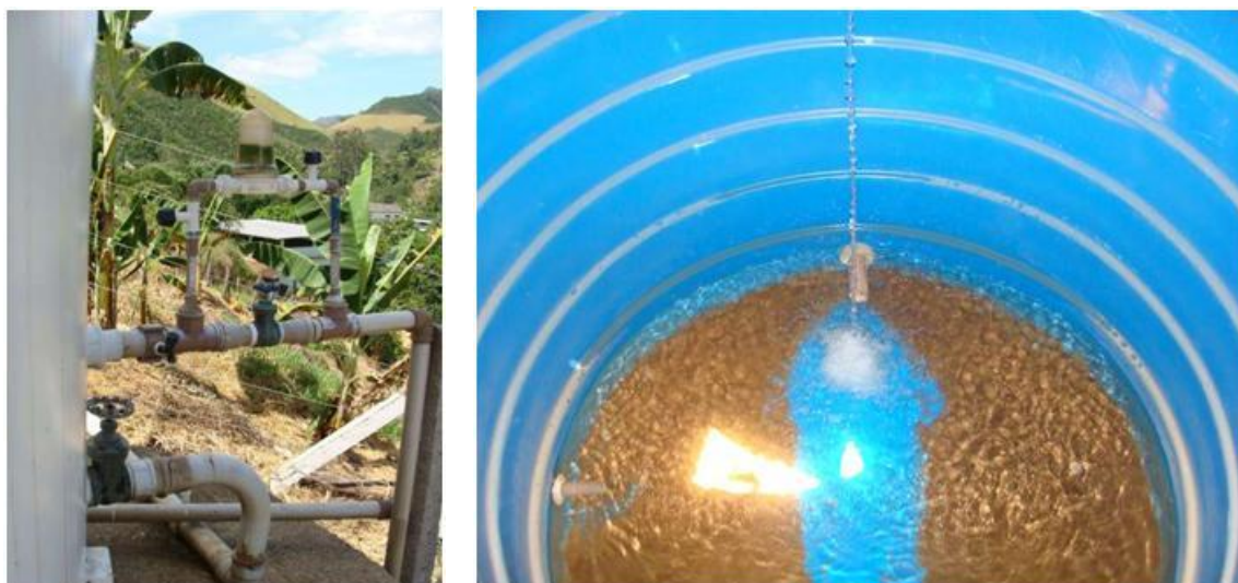
Figura 46: a) Sistema de cloração; e b) Resíduos no fundo do reservatório de Duas Barras.
