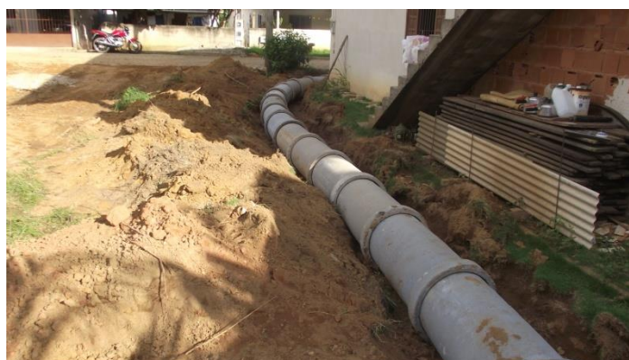
Figura 82: Ilha de Santo Inácio – Bom Destino: Rede executada em caráter emergencial. Redes do bairro estão sub-dimensionadas e assoreadas
