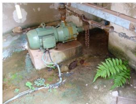
Figura 30: Vazamento de água no interior da elevatória de Taquaral.
