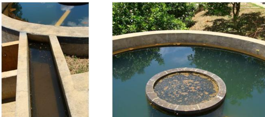
Figura 36: a) Canal de água floculada; e b) Decantador circular.
