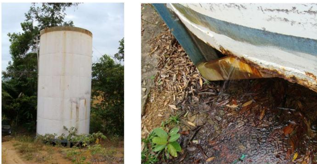
Figura 31: a) Reservatório Alto Taquaral; e b) Vazamento devido à corrosão na base.
