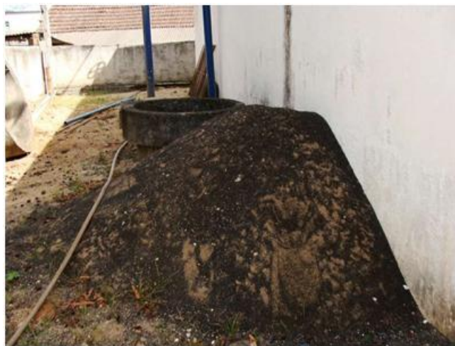
Figura 21: Perda de leito filtrante na ETA Iconha.
