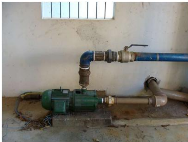
Figura 28: Sistema de bombeamento da elevatória do Bairro Morada Vale do Sol.
