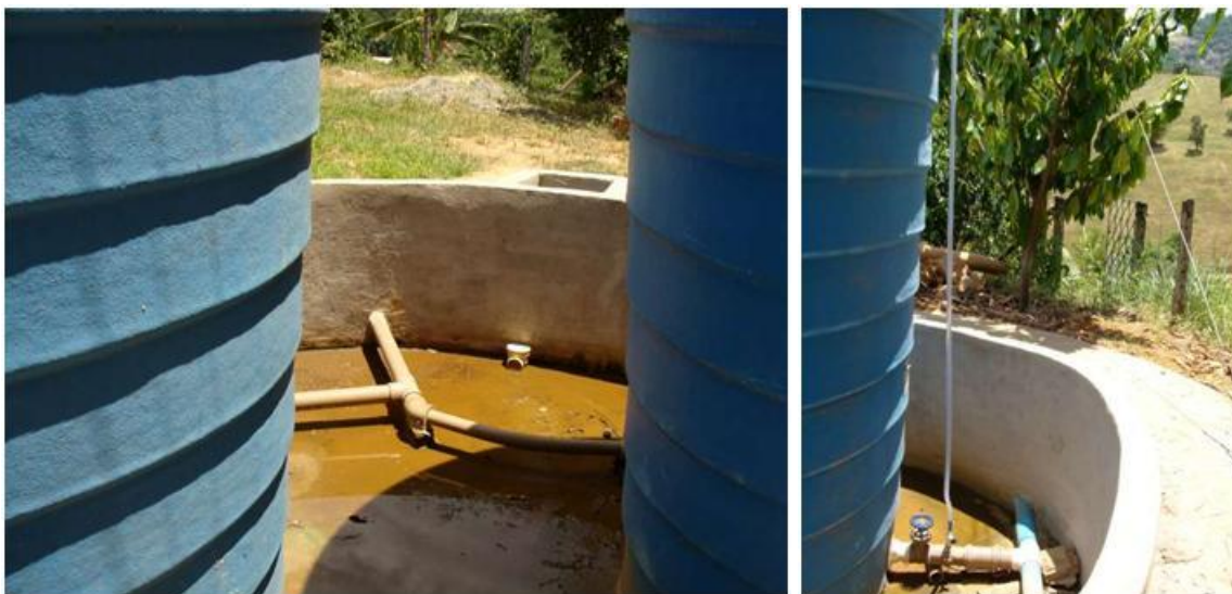
Figura 41: a) Rede de abastecimento de Bom Destino (Tubulação Marron); e b) Rede de Crubixá (Tubulação Azul).
