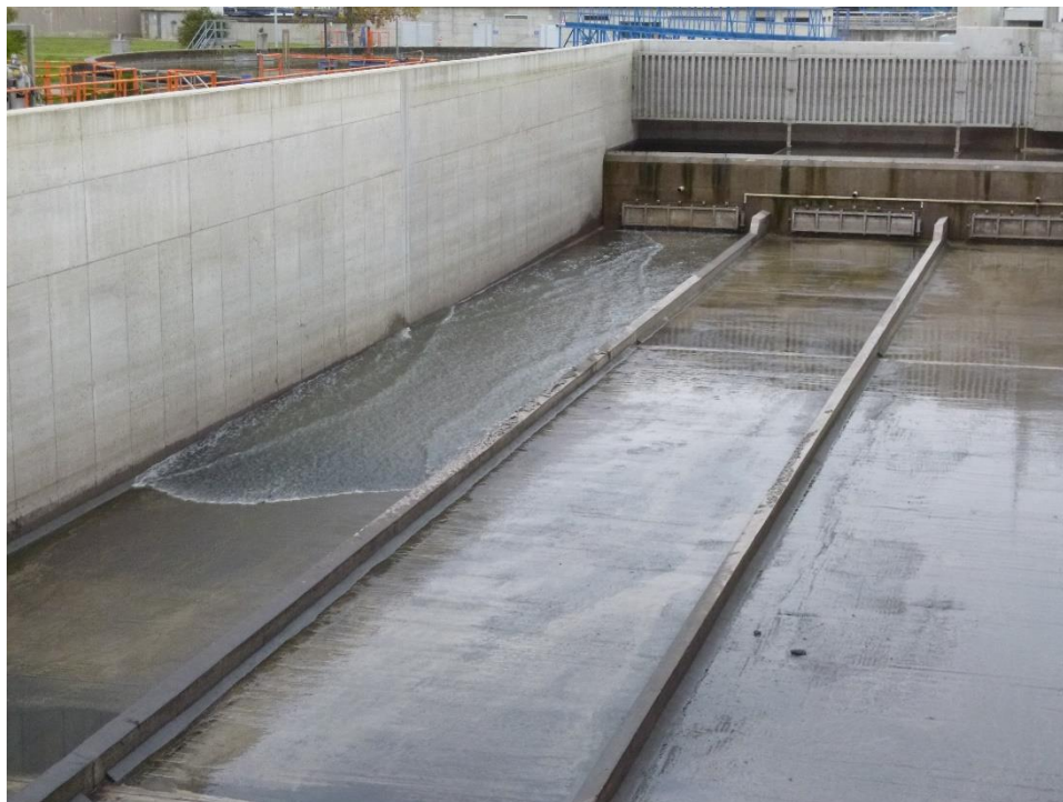
Figura 10 – Sistema de limpeza automática de águas de primeira chuva da ETE Mancasale, Reggio Emilia, Itália operada pela Iren Emilia S.p.A.
